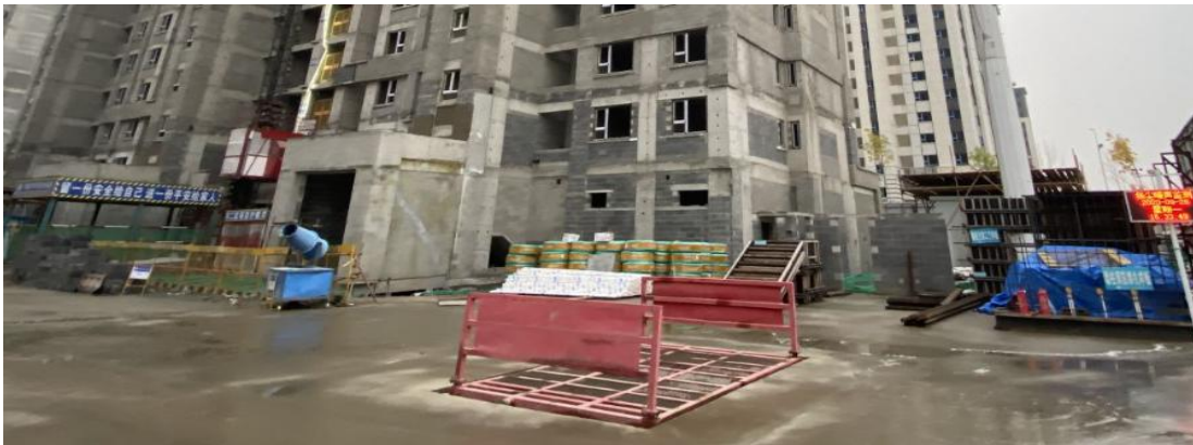
图 2-5 洗车槽现场照片
