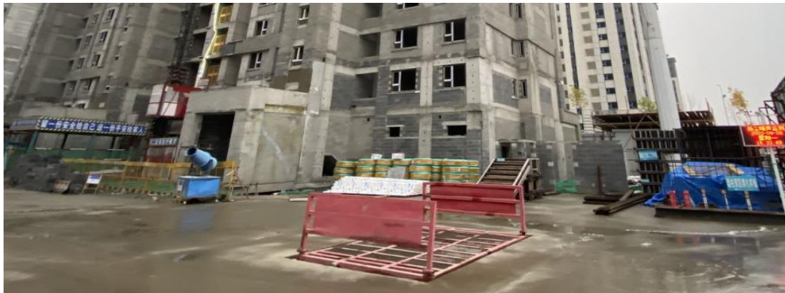
图 2-5 洗车槽现场照片
